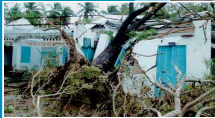
Im Dezember 2006 vollständig zerstört durch den Taifun Durian: die Tan Loi Thanh Mittelschule
